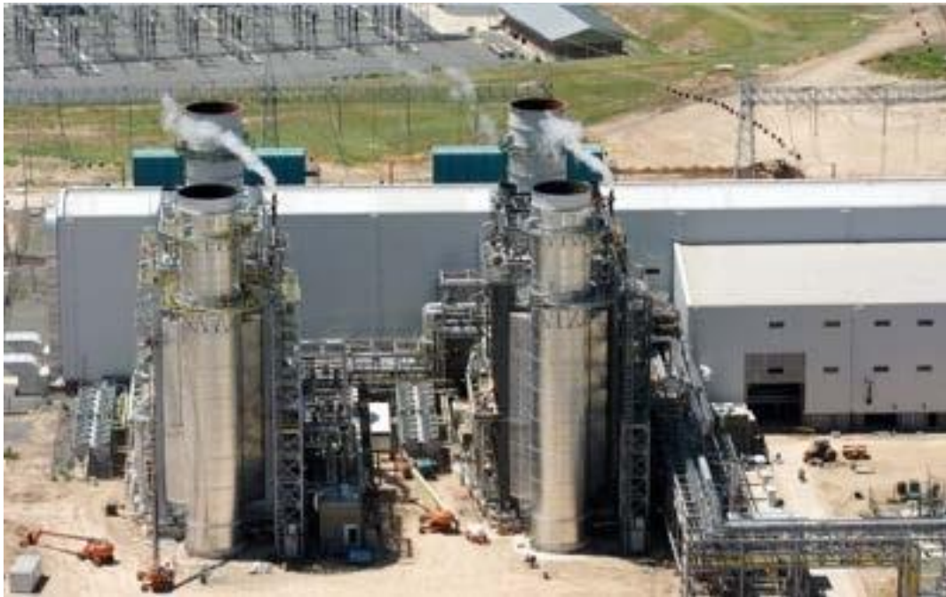
Central Termoeléctrica de ciclo combinado – Manuel Belgrano I – Buenos Aires
